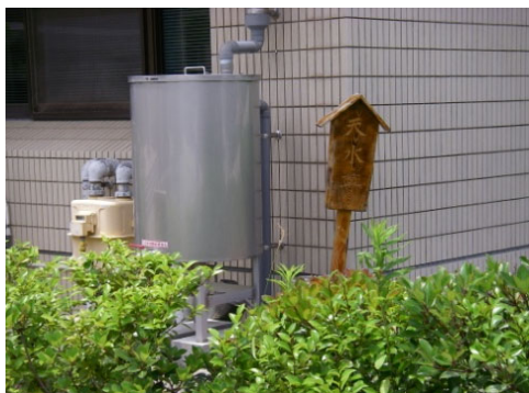
雨水タンク (西3号館)
